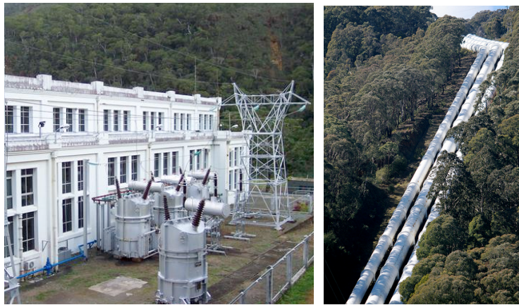
FIG. 5 – Conduites forcées et centrale hydroélectrique.
