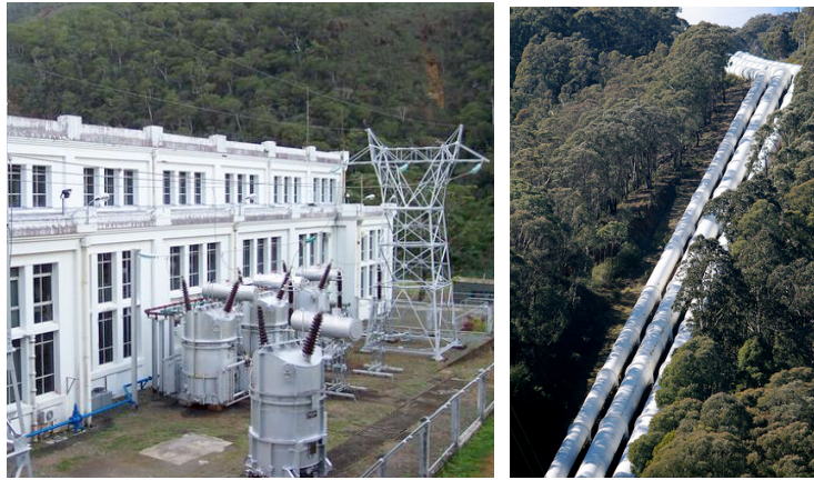
FIG. 3.18 – Conduites forcées et centrale hydroélectrique.
