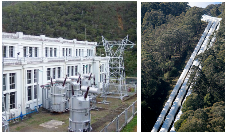
FIG. 3.18 – Conduites forcées et centrale hydroélectrique.
