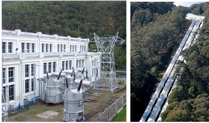
FIG. 10 – Conduites forcées et centrale hydroélectrique.
